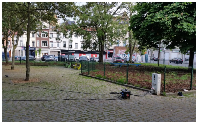
10) Vue sur une borne d'accès à l'électricité contre l'espace réservé aux chiens, devant le parking de la rue Jourdan
